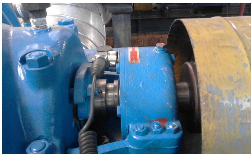
Slika 21. Ispravno postavljena mjerna sonda na mjerno mjesto CPV1-3A
