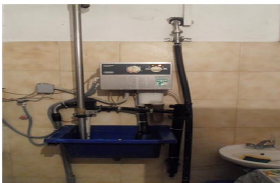
Slika 4. Postrojenje za pranje izmuzišta (Izvor: vlastita fotografija)
