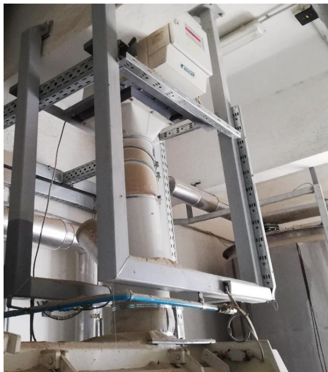
Slika 27. Cijev za dovod krutog sastava smjese do homogenizatora (Fotografija: Janješić, 2019.)
