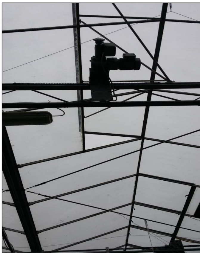
Slika 12. Krovno prozračivanje unutar vrtnog centra Floreo d.o.o.
