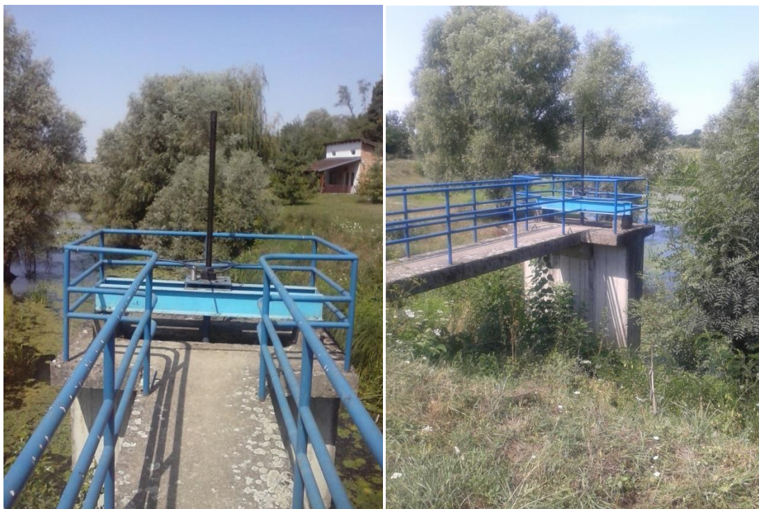
Slika 29. Ustava na Gatskom kanalu (foto F.Vrbanić)
