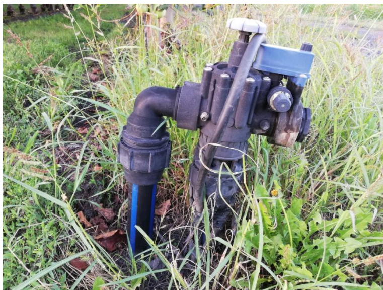
Slika 9: Razvodna stanica na koju se spaja polietilenska cijev za navodnjavanje izvor: Mirna Škoro (2019.)
