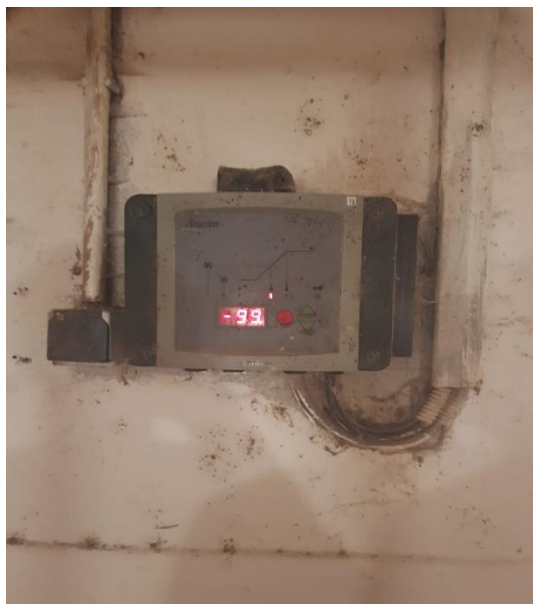
Slika 3. Upravljačka jedinica za ventilaciju proizvodnog objekta
