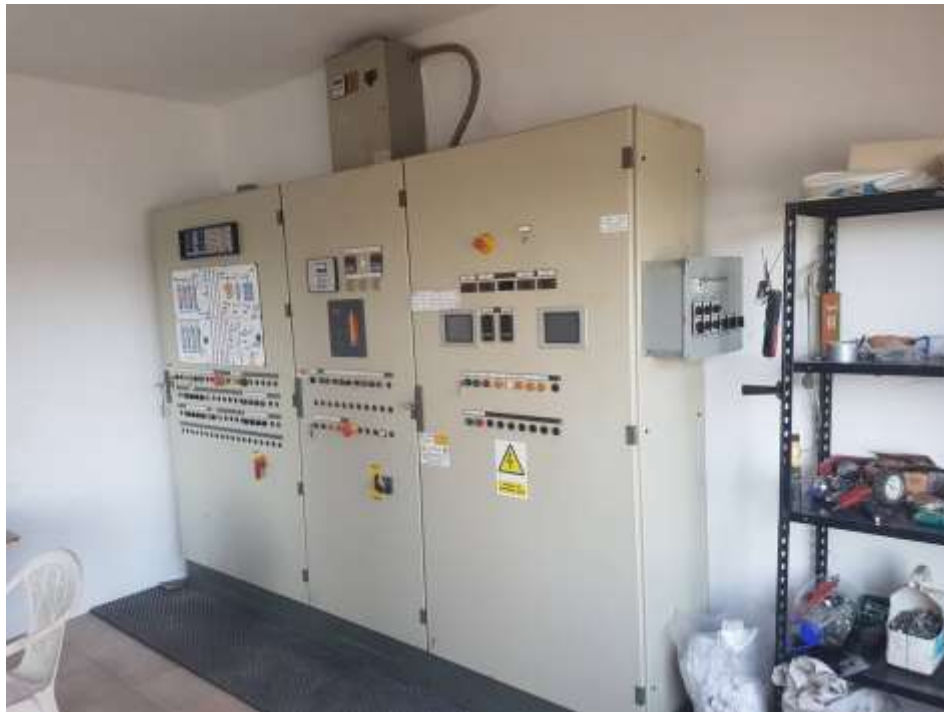
Slika 10. Upravljačko-rasklopní ormar (Izvor: Lukačević, M.)
