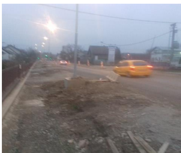
Slika 4) Postavljena rasvjetna tijela (Izvor: Autor, 2020.)
