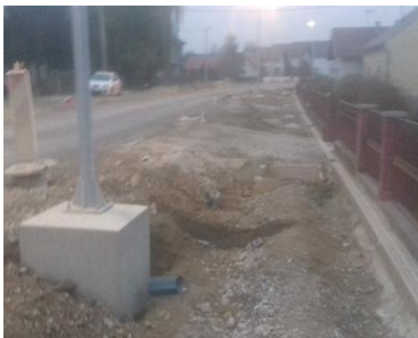
Slika 6) Betonska podnožja rasvjetnih tijela (Izvor: Autor, 2020.)
