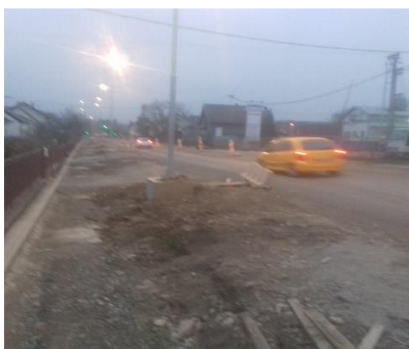
Slika 4) Postavljena rasvjetna tijela (Izvor: Autor, 2020.)
