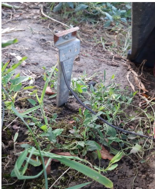
Slika 14. Uzemljenje (Dodigović M., travanj 2021)
