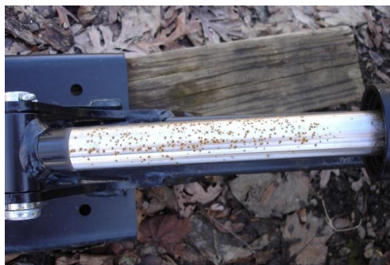
Slika 23. Hidraulički cilindar zahvaćen korozijom
