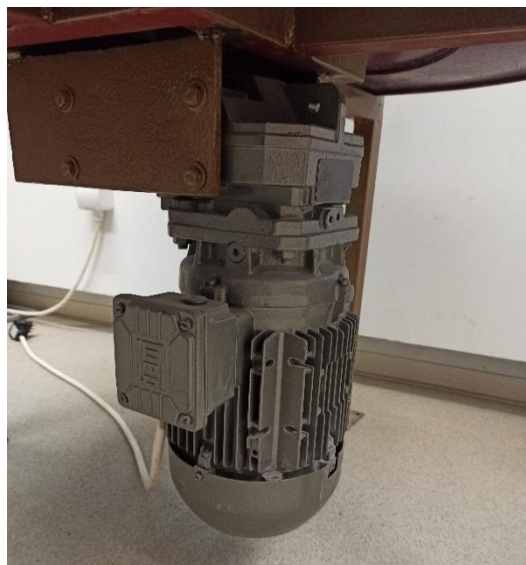
Slika 15. Pogonski elektromotor WEG watt drive w21 s reduktorom
