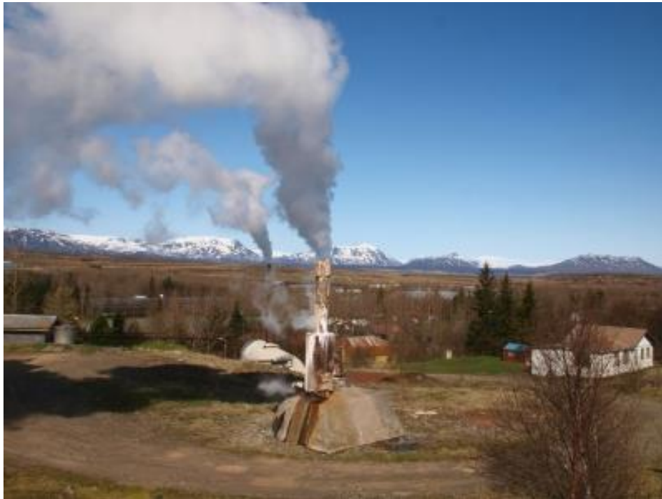
Slika 14. Geotermalna crpna stanica za staklenike Fridheimar na Islandu ( https://www.fridheimar.is )
