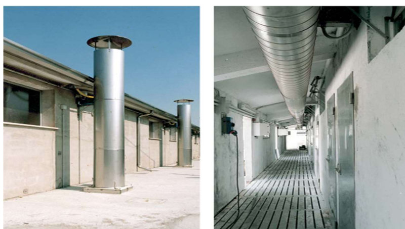
Slika 25. Ventilacijski kanali (Izvor: www.worldstainless.org )
