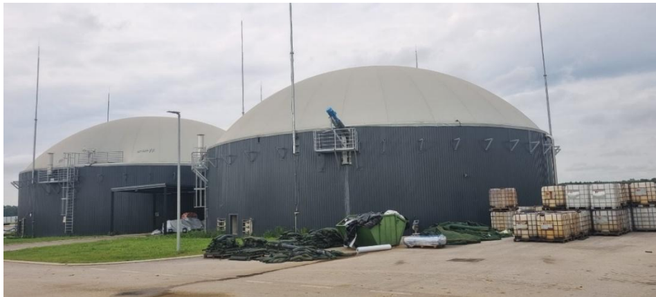
Slika 8. Digestor i postdigestor
