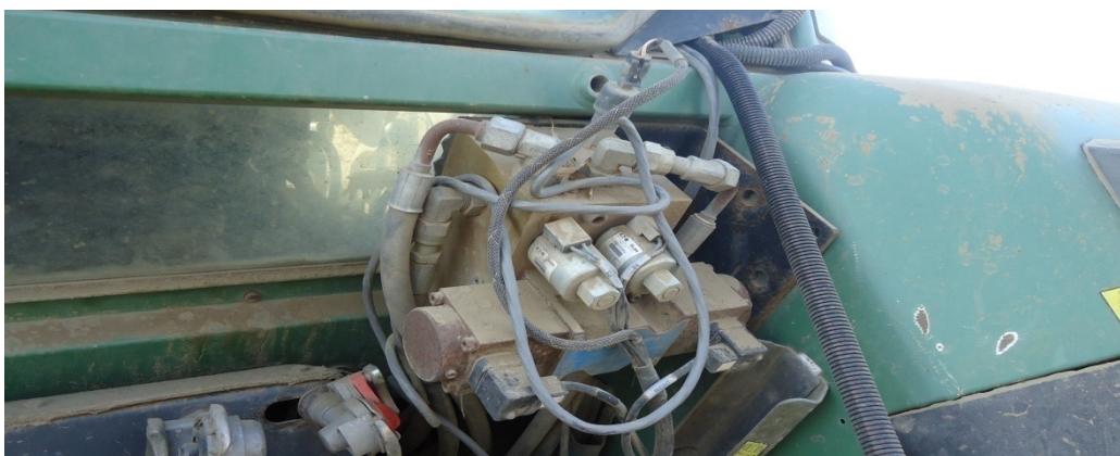
Slika 54. Hidraulički blok za automatsko upravljanje.
