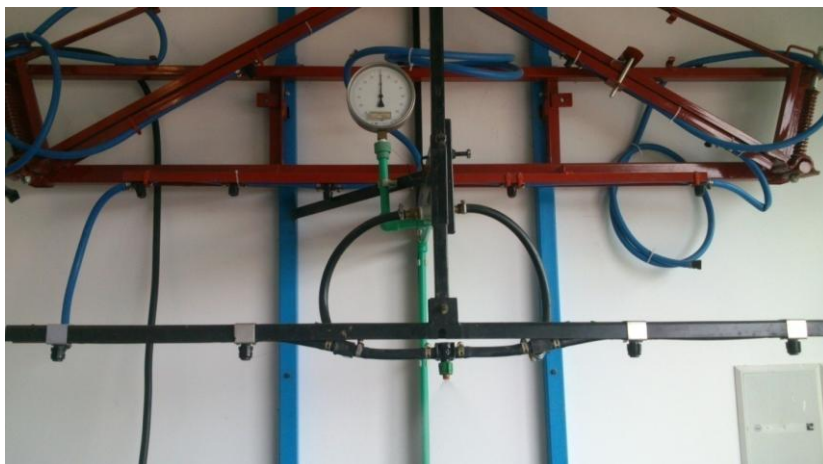
Slika 24. Podešeni tlak na ispitnoj stanici HR-004.
