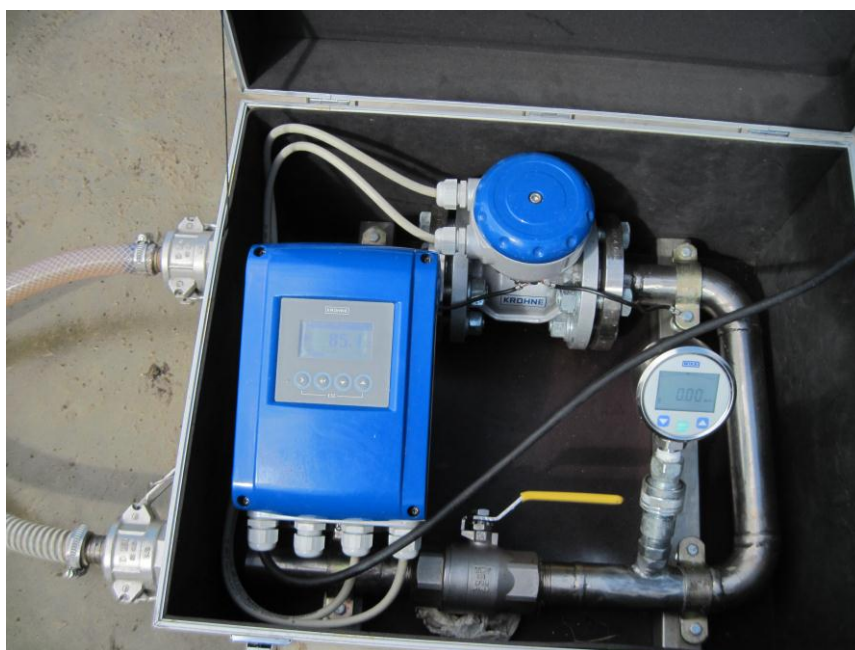
Slika 15. Uređaj za kontrolu protoka crpke Krohne
