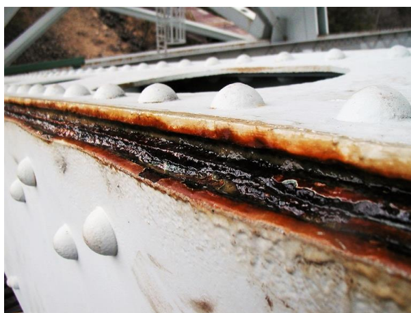
Slika 14. Procjepna korozija konstrukcije mosta
