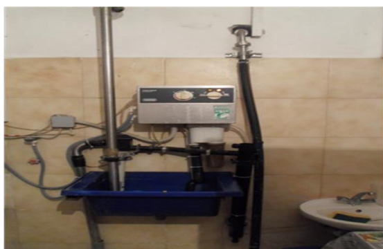
Slika 4. Postrojenje za pranje izmuzišta (Izvor: vlastita fotografija)
