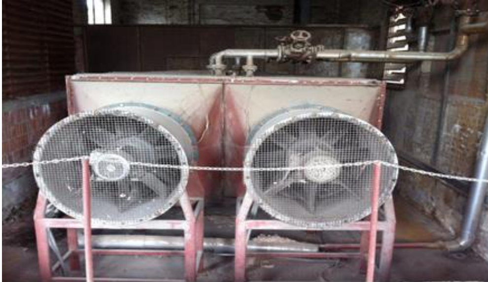
Slika 11. Ventilator i izmjenjivač topline (Izvor: vlastita fotografija)
