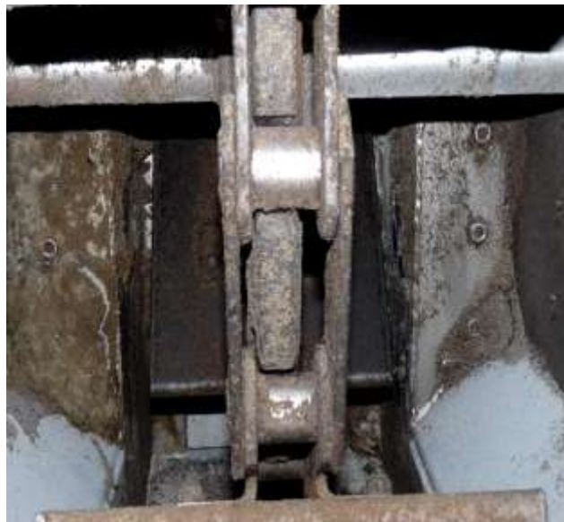
Slika 8. Tribokorozija lanca elevatora (Izvor: Rozing i sur., 2015.)
