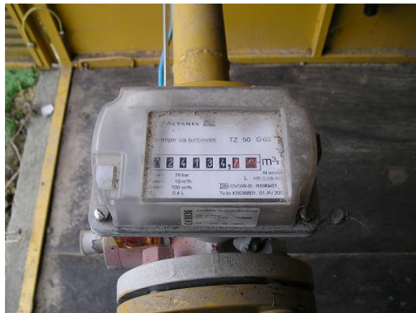
Slika 19. Mjerenje potrošnje plina plinskom turbinom (vlastita fotografija)
