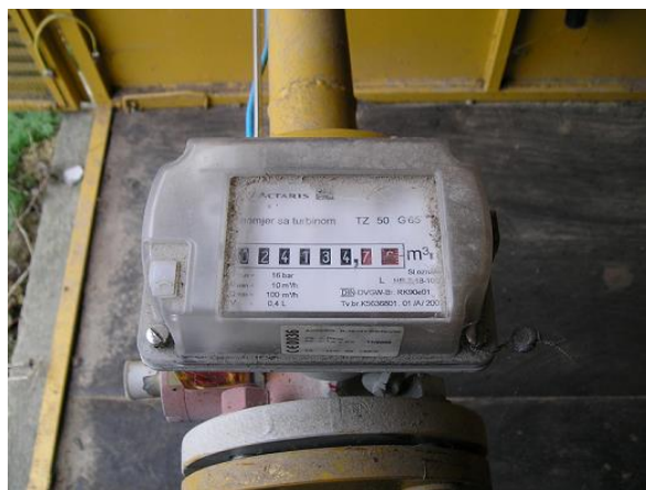
Slika 19. Mjerenje potrošnje plina plinskom turbinom (vlastita fotografija)
