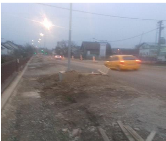
Slika 4) Postavljena rasvjetna tijela (Izvor: Autor, 2020.)
