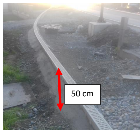
Sl.11) Izvedba kanalice koja je 50 cm viša od razine dvorišta u susjednom dvorištu. (Izvor: Autor, 2020.)
