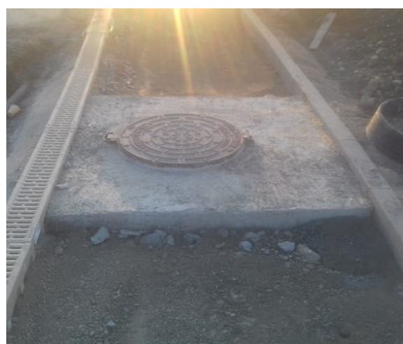
Slika 5) Šahtovi uz kanalice koje upijaju oborinsku vodu (Izvor: Autor, 2020.)
