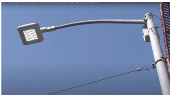
Sl. 18) Primjer LED rasvjetnog tijela s“ rukom“ i solarom
