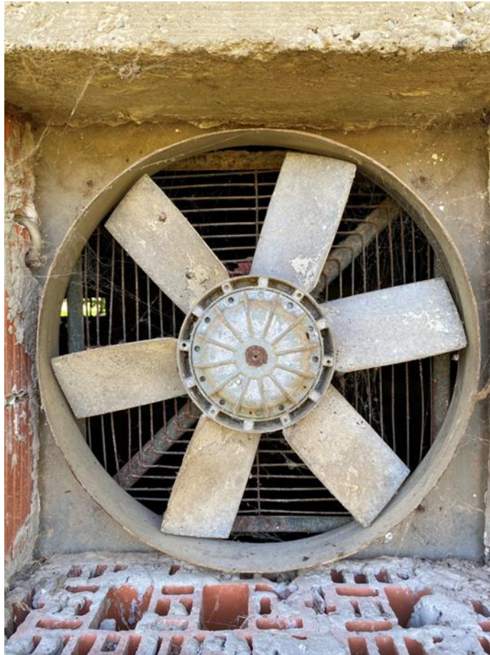
Slika 15. Aksijalni ravni ventilator Izvor: Vlastiti izvor (Hamm)
