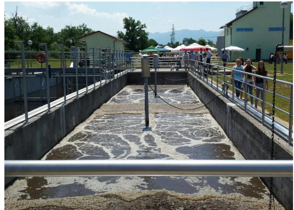
Sl. 27. Objekti za pročišćavanje otpadnih voda grada Gospića
