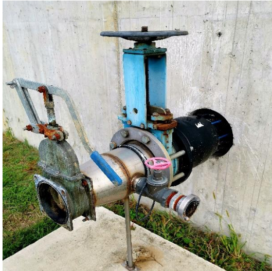
Slika 24. Ventil za ispuštanje tekuće frakcije digestata (Izvor: vlastita fotografija, 2021.)
