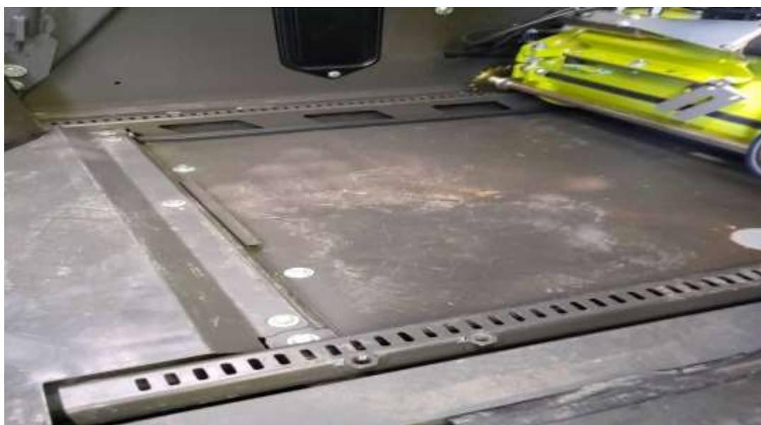
Slika 27. Na slici je vidljiva nova oplata i zaštitni limovi (Izvor: Vlastita fotografija)
