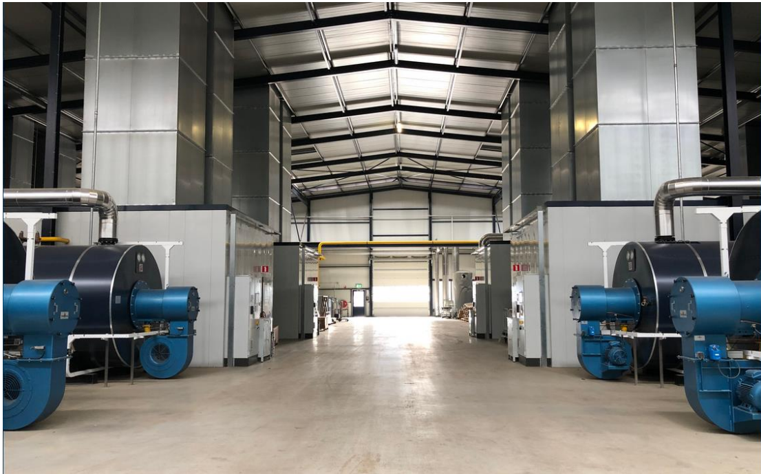
Slika 11. Geotermalno postrojenje u staklenicima Hoogweg u Nizozemskoj ( https://www.hoogweg.nl )
