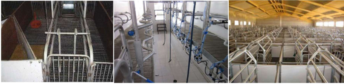
Slika 20. Ograde, kapije i pregrade od nehrđajućeg čelika
