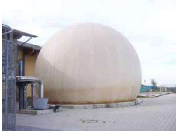
Slika 23. Vanjsko niskotlačno spremište za skladištenje plina.
