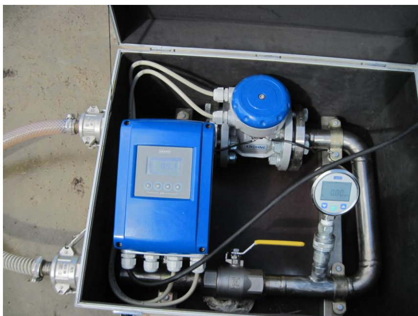
Slika 15. Uređaj za kontrolu protoka crpke Krohne
