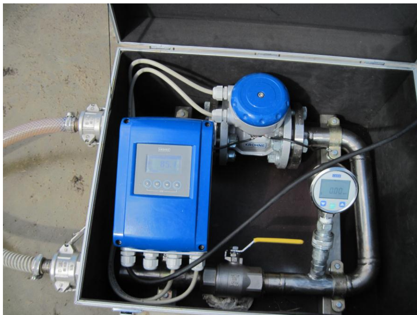
Slika 15. Uređaj za kontrolu protoka crpke Krohne
