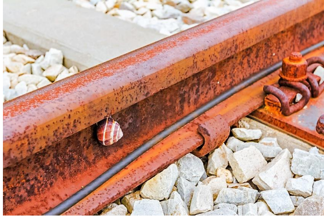
Slika 5. Elektrokemijska korozija tračnice i spojeva željezničke pruge
