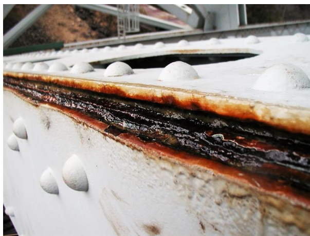
Slika 14. Procjepna korozija konstrukcije mosta
