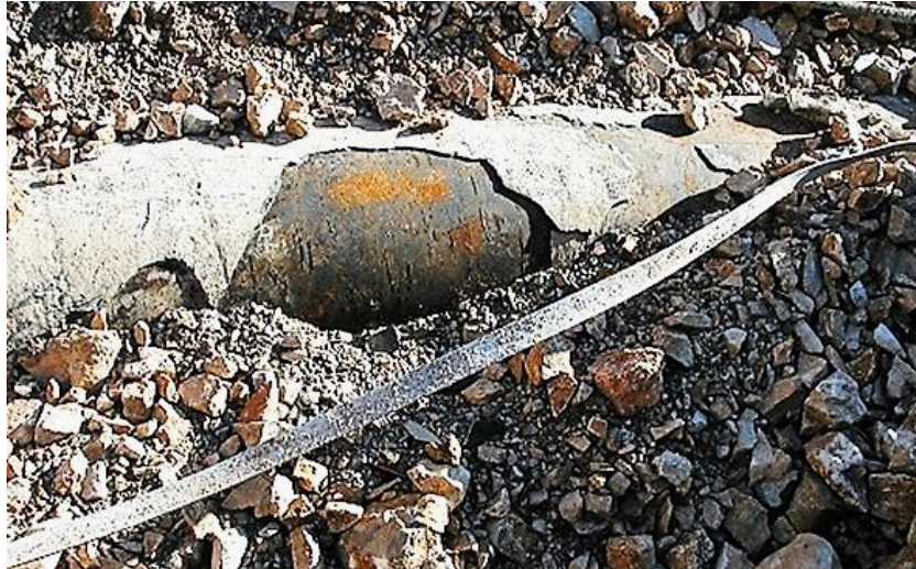
Slika 22. Korozija podzemnog spremnika
