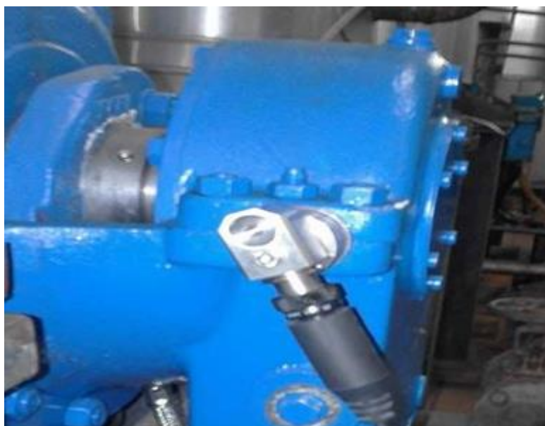
Slika 20. Ispravno postavljena mjerna sonda na mjerno mjesto CPV1-4H
