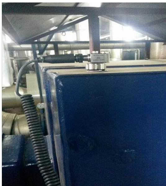
slika 22. Ispravno postavljena mjerna sonda na mjerno mjesto CPV1-1V
