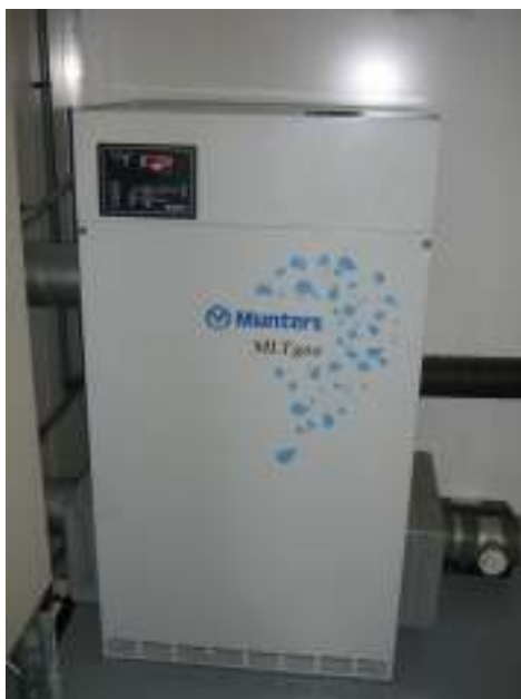
Slika 31. Dehumidifikator Munters MLT 800. Autorska fotografija.
