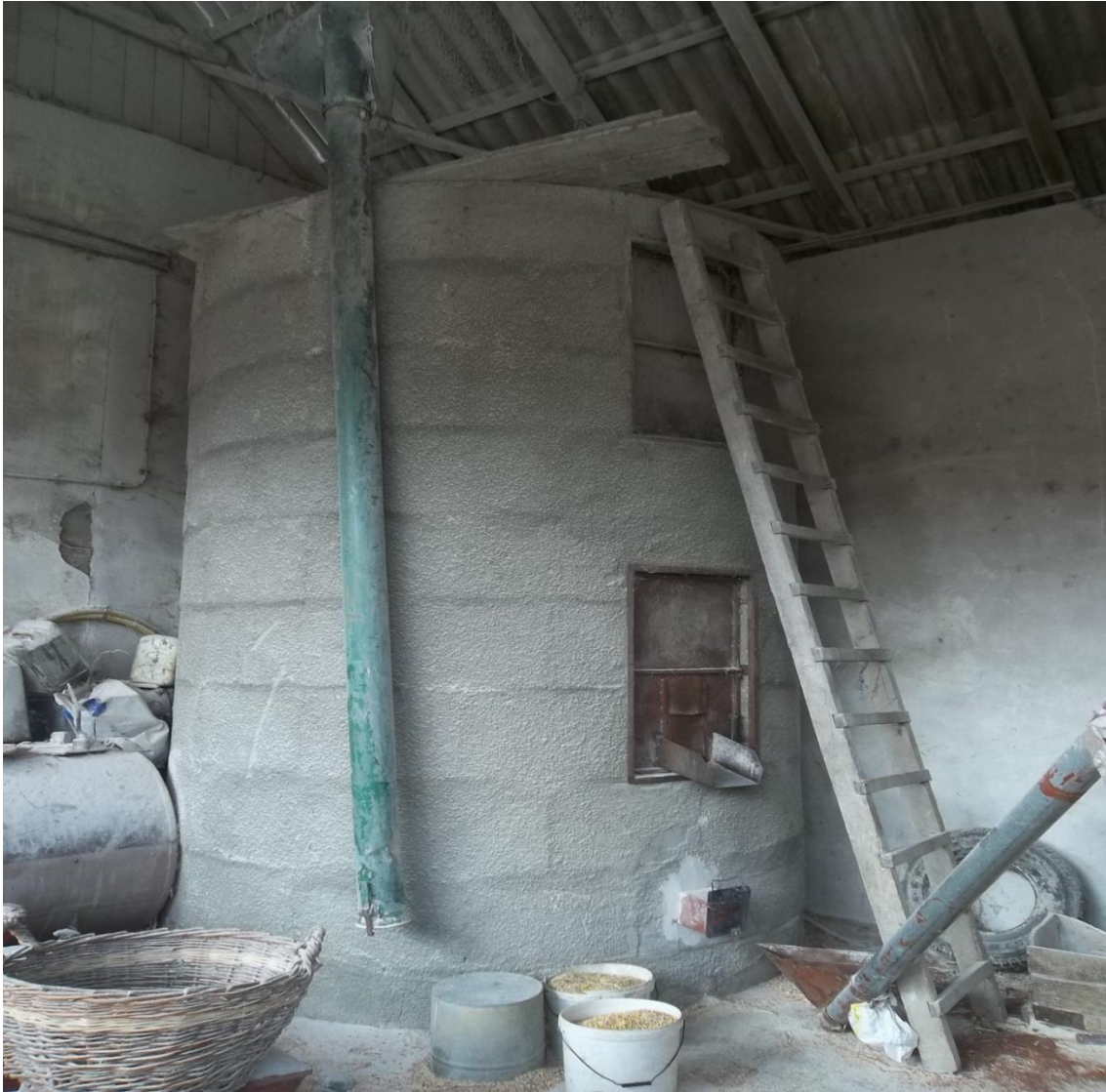
Slika 8. Betonski silos kapaciteta 20 tona na OPG-u Pažur Anica (izvor: Mislav Pažur)
