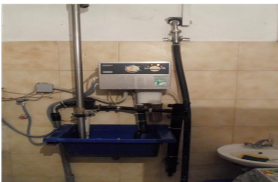
Slika 4. Postrojenje za pranje izmuzišta (Izvor: vlastita fotografija)
