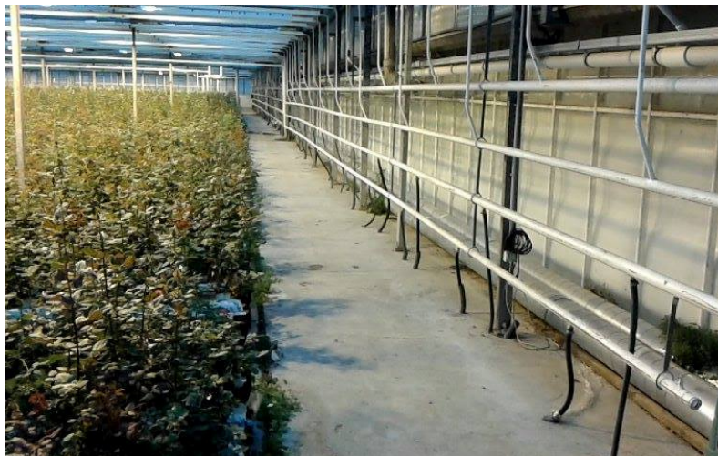
Slika 20. Cijeviza grijanje staklenika na bočnim stranama
