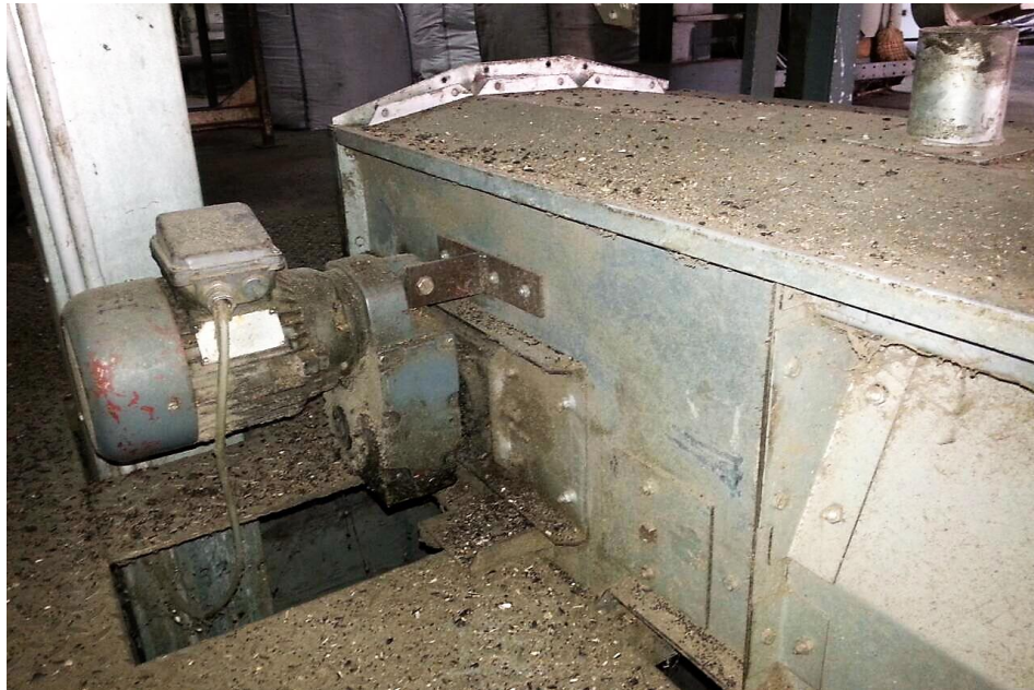
Slika 27. Pogonski motor na trakastom transporteru (Fotografija: Đurkić, 2018.)
