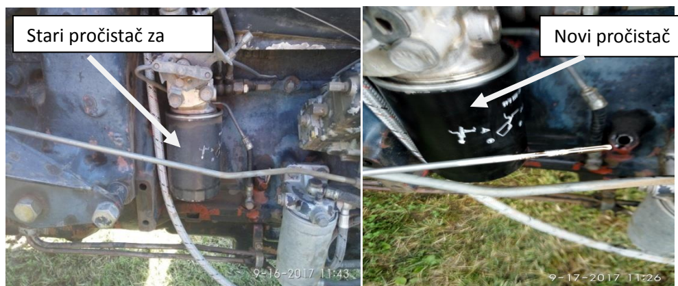
Slika 3. Izgled starog i novog pročištača za ulje (izvor: autor)
