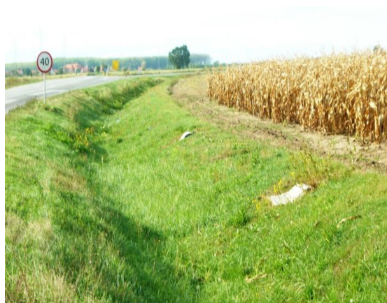
Slika 16. Kanal za odvodnju za izvodima lizimetarskih posuda
