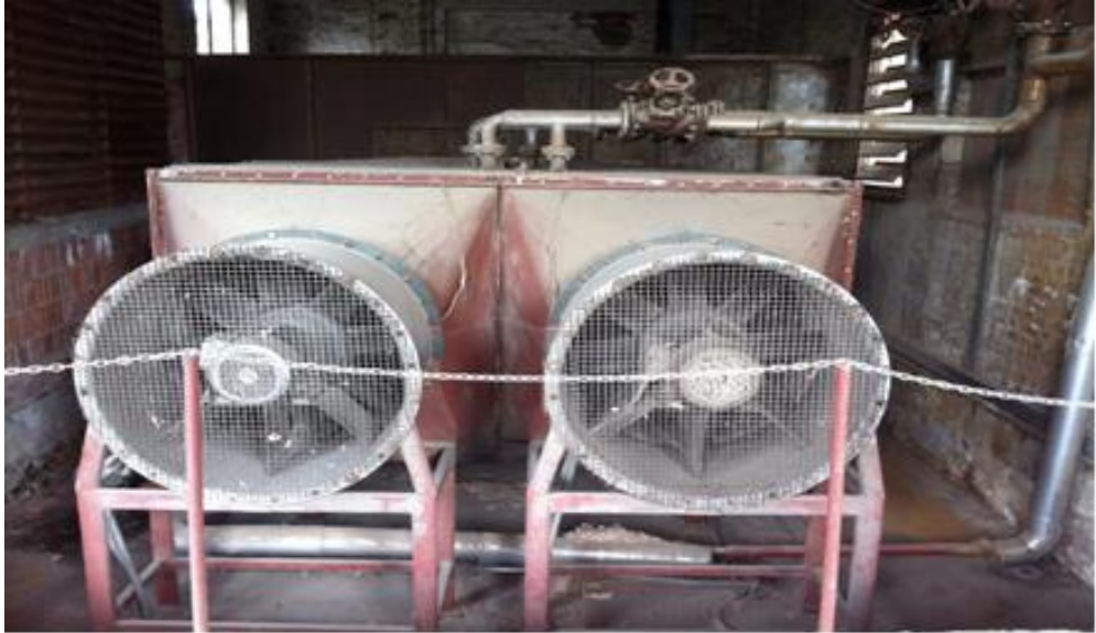
Slika 11. Ventilator i izmjenjivač topline (Izvor: vlastita fotografija)
