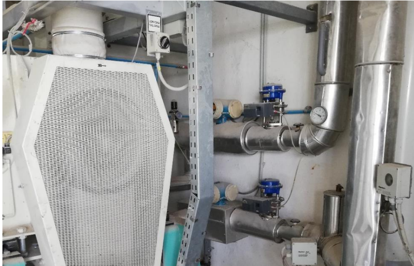
Slika 28. Cijevi za dovod tekućeg sastava smjese do homogenizatora (Fotografija: Janješić, 2019.)
