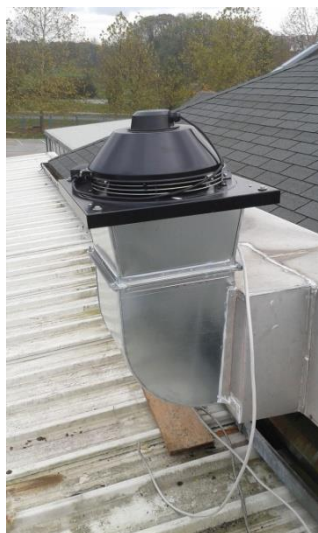
Slika 20. Ventilacija izrađena od nehrđajućeg čelika
