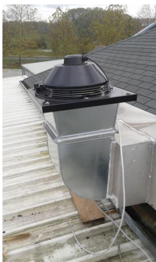
Slika 20. Ventilacija izrađena od nehrđajućeg čelika
