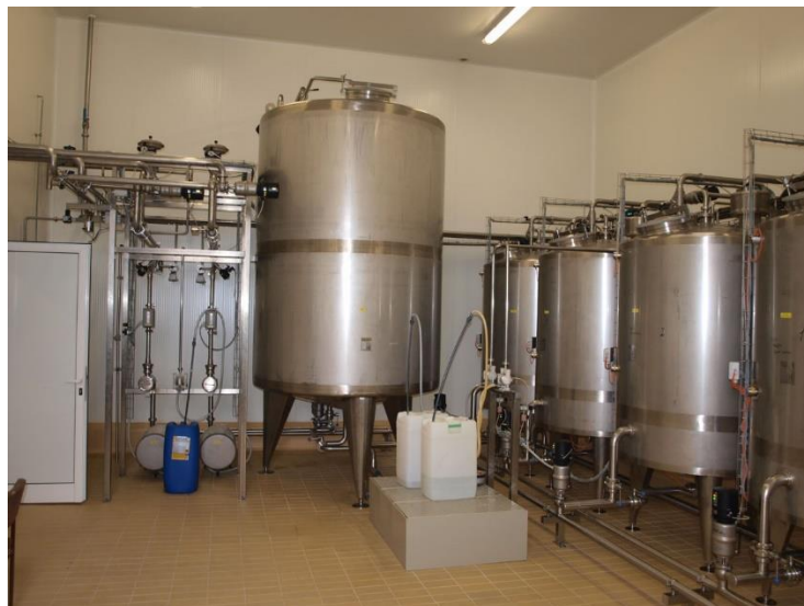
Slika 12. Stanica za sanitacije zatvorenih sustava postrojenja
