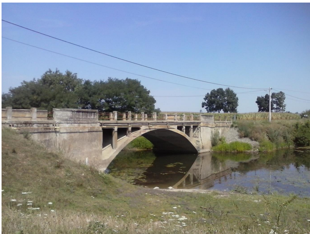
Slika 28. Most na Karašici kod gatskog kanala (foto F. Vrbanić)
