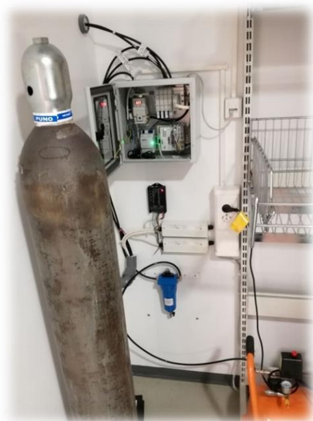
Slika 20. Kontrolna upravljačka jedinica (Foto: Milaković, 2019.)
