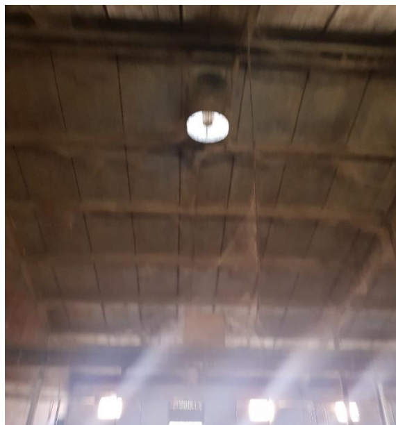
Slika 4. Ventilacija u proizvodnom objektu
