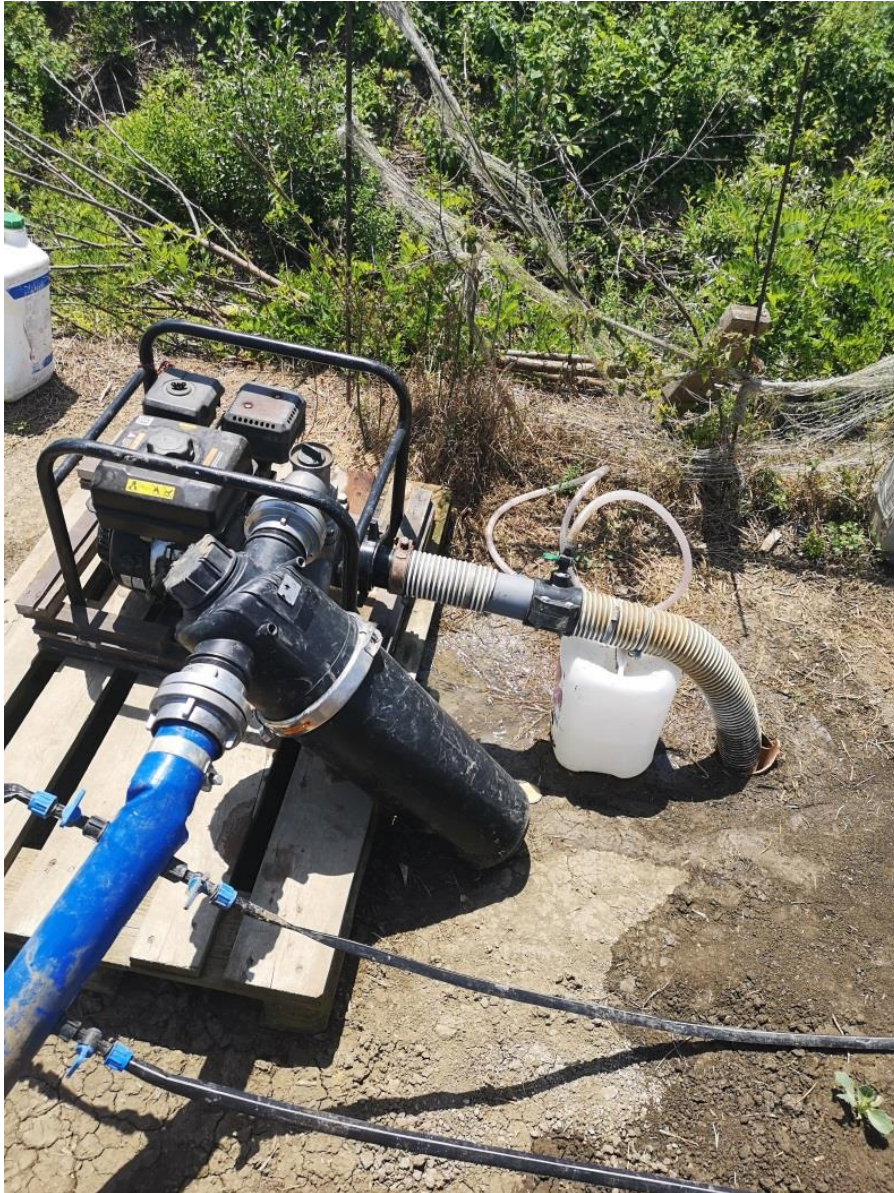
Slika 4. Vodozahvat podzemne vode s crpnim agregatom
