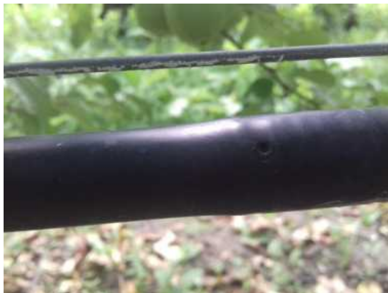
Slika 12. Predviđeni otvori (kapaljke) na plastičnim cijevima (Izvor: Vlastita fotografija)
